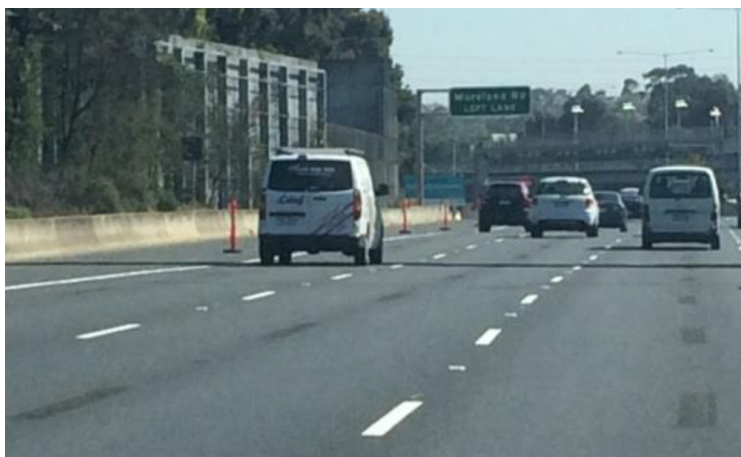
Abbildung 4.2-3: Entfernte Bodenmarkierung mit sichtbaren Rückständen (Austroads, 2017)
