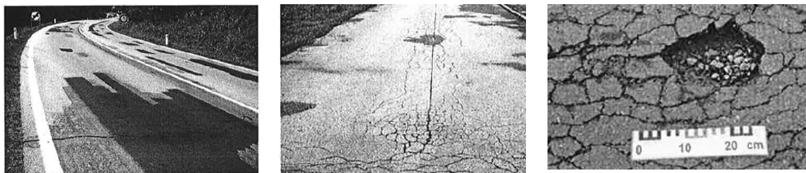
Abbildung 2.3-1: Fahrbahnschadensbilder anhand der RVS 13.01.11
