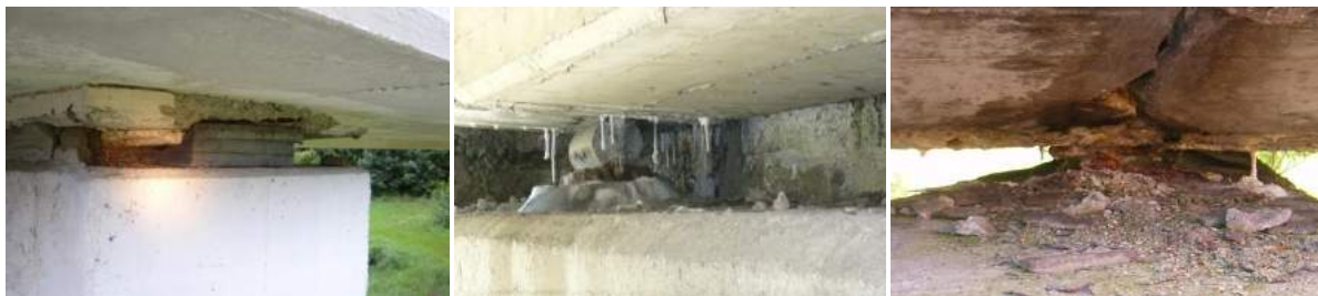
Abbildung 5 typische Schäden an Brückenlagern
